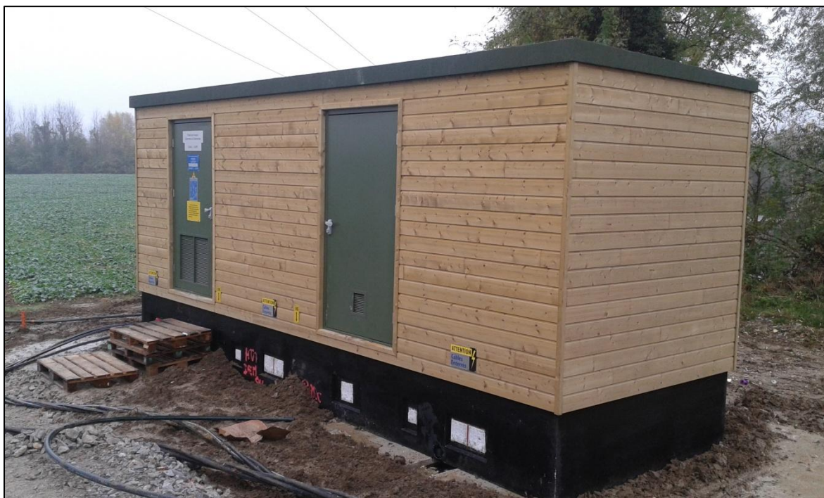
Figure 7 : Poste de livraison du parc éolien de Leury, commune de Crouy.
